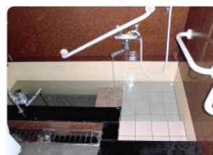
自由設計の階段式浴槽なのでお湯の深さはお好みどおり半身浴も可能です。タイルの色別で段差が判りやすくなりました。
