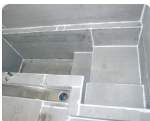
低階段式浴槽を施工して高齢者が入浴しやすく介護が楽になりました。自由設計なので場所を選びません。
