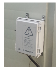
空調機制御システム
